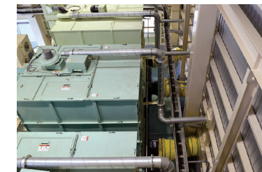
乾燥機排塵ダクト
