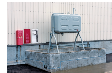
燃料タンク・防油堤
