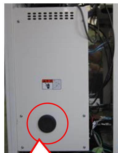
昇降機用サーマル リレーの確認用の窓
